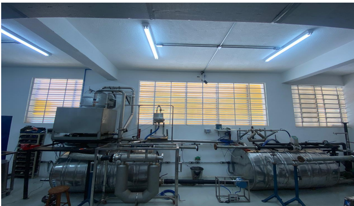
Figura 1 – Bancada de Vazão Antiga - Sem Automação
